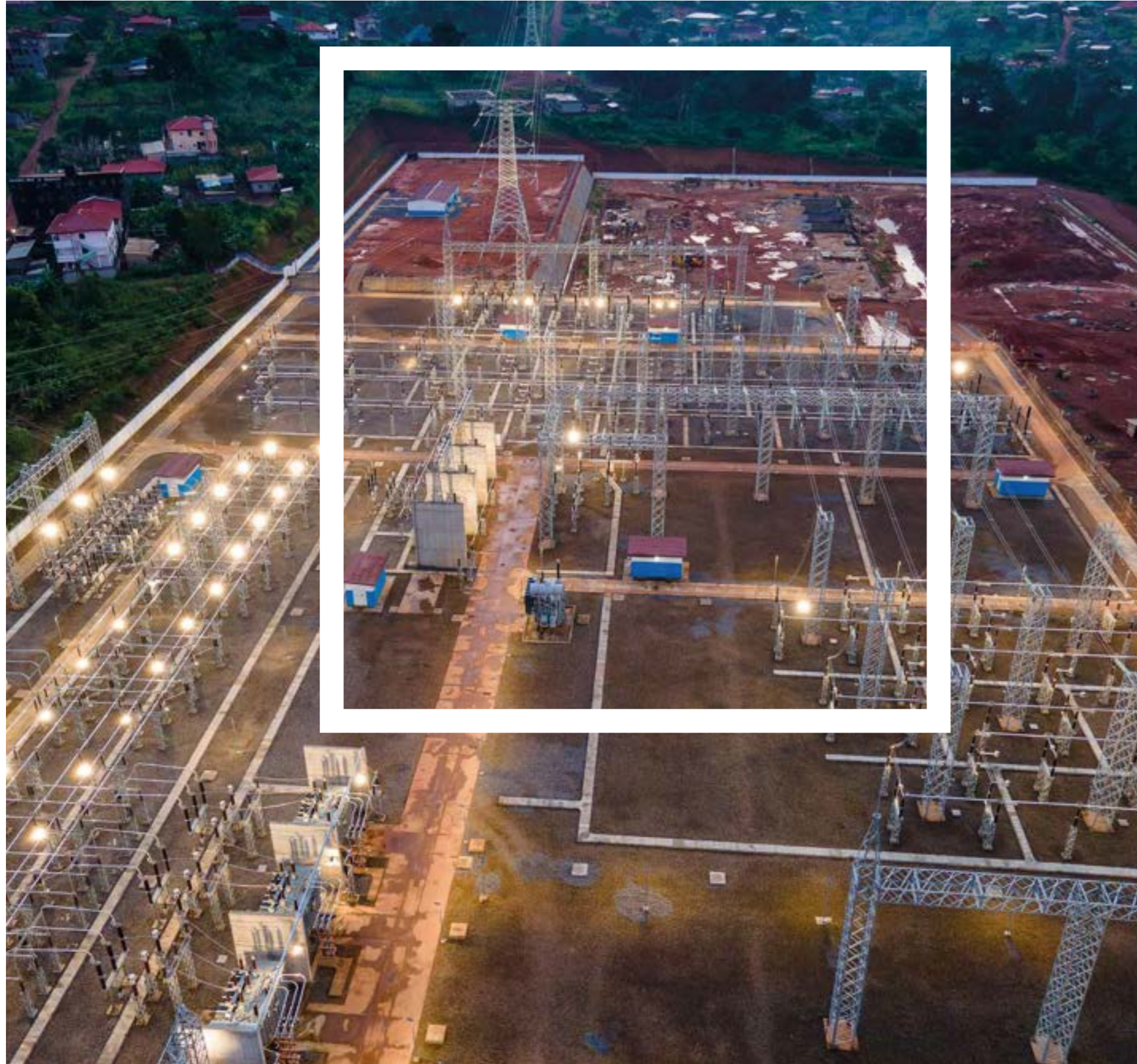
Subestación Nyom, Yaoundé (Camerún)
