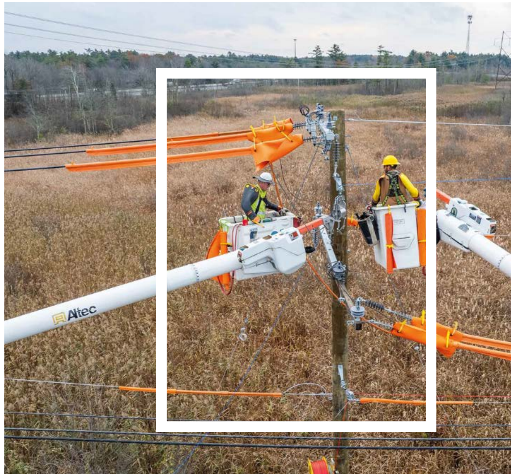
Línea transmisión y distribución en Portsmouth, New Hampshire (Estados Unidos). Elenor Hawkeye
