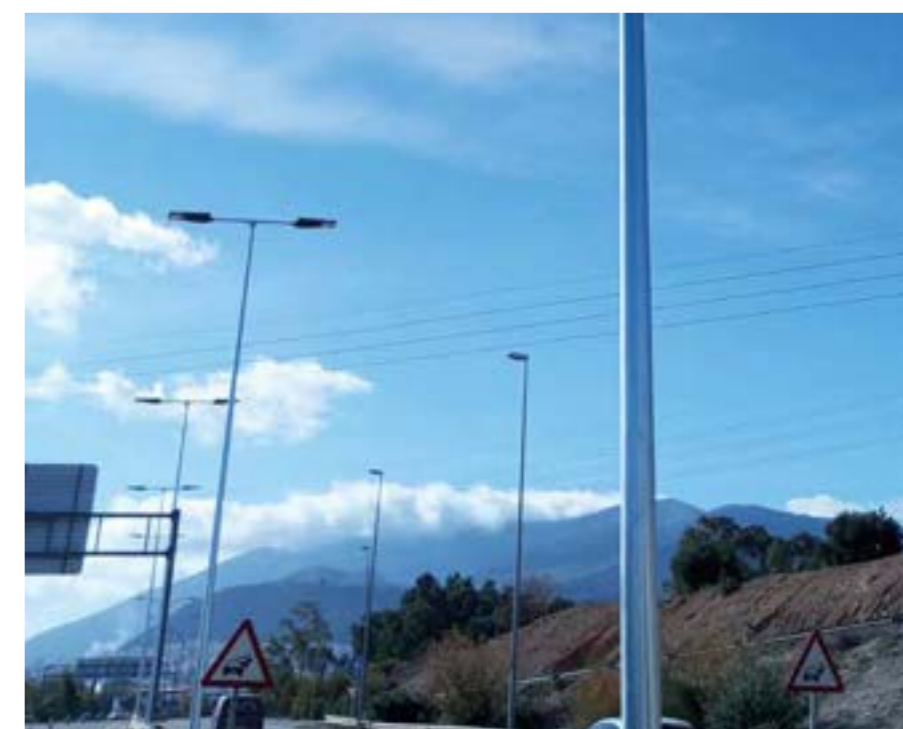
Alumbrado público en carreteras, Jaén (España)
