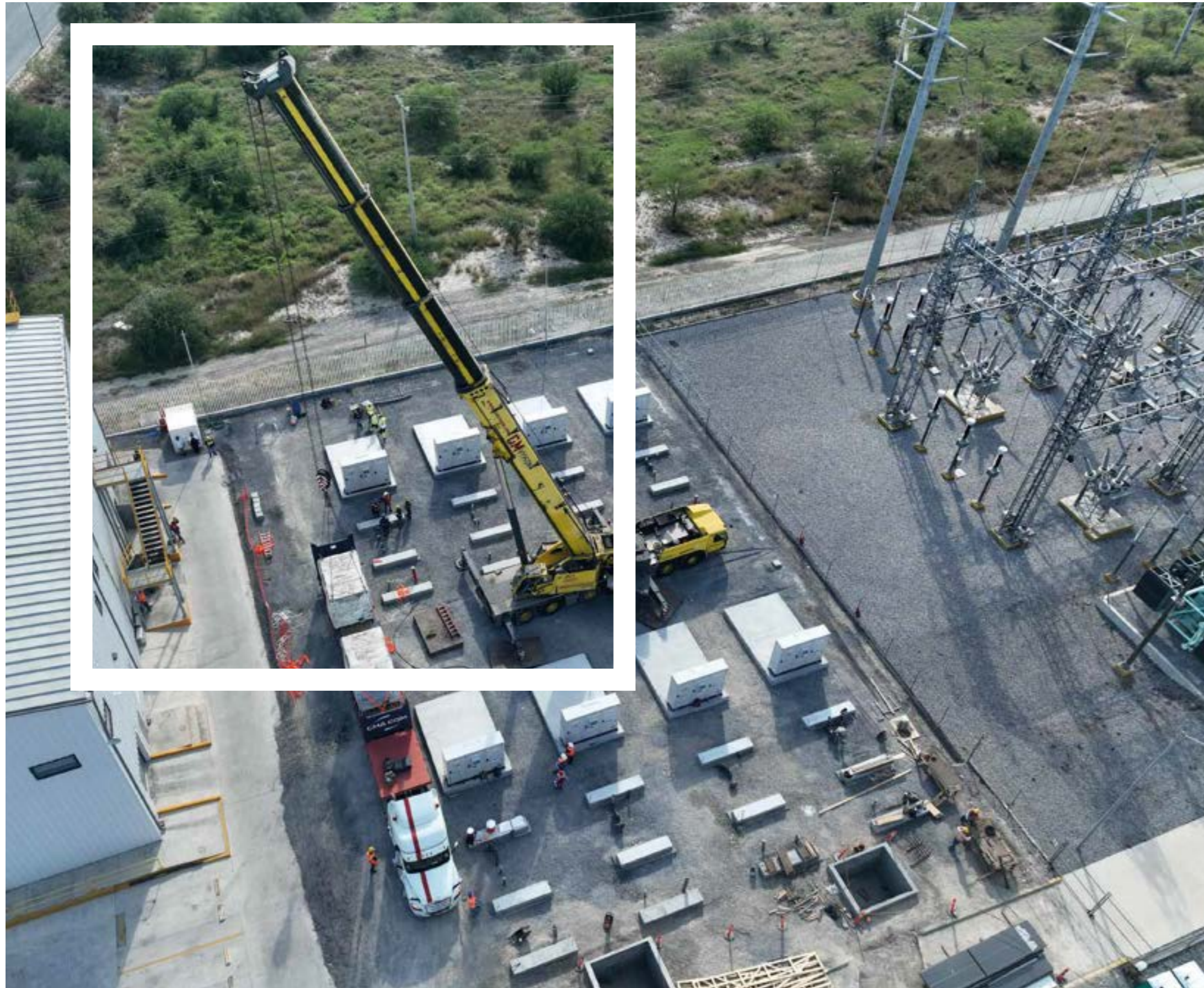
Almacenamiento con baterías BESS en Monterrey (México)
