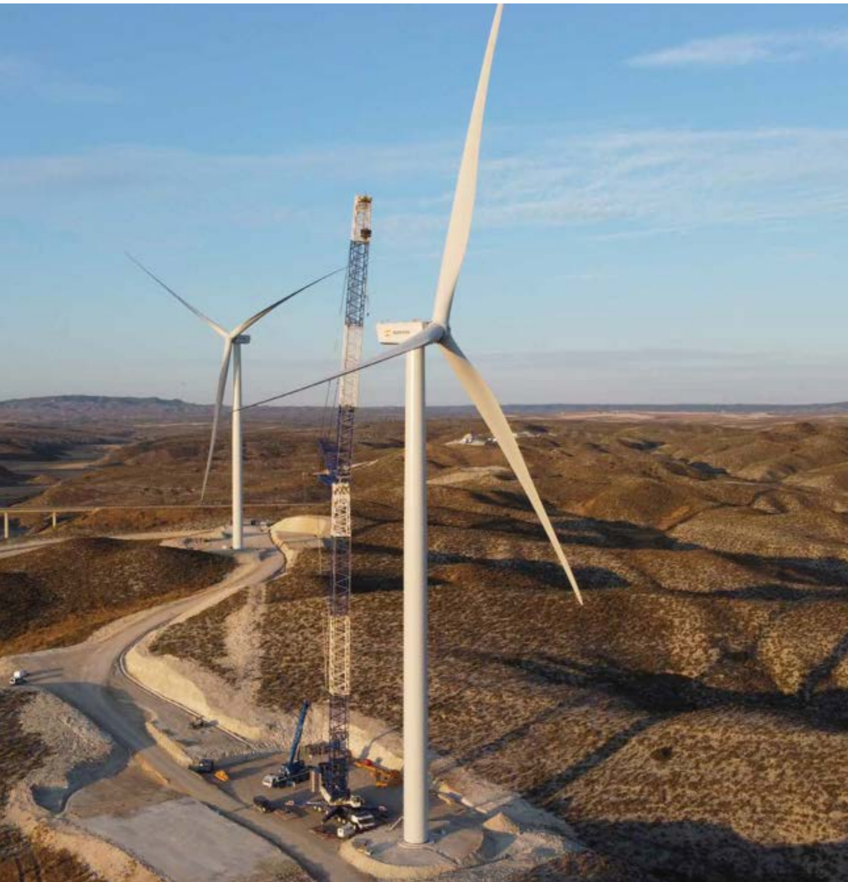
Complejo Eólico Monlora, Zaragoza (España)
