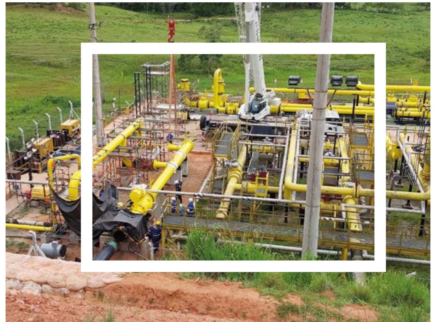
Gasoducto Gasig (Brasil)
