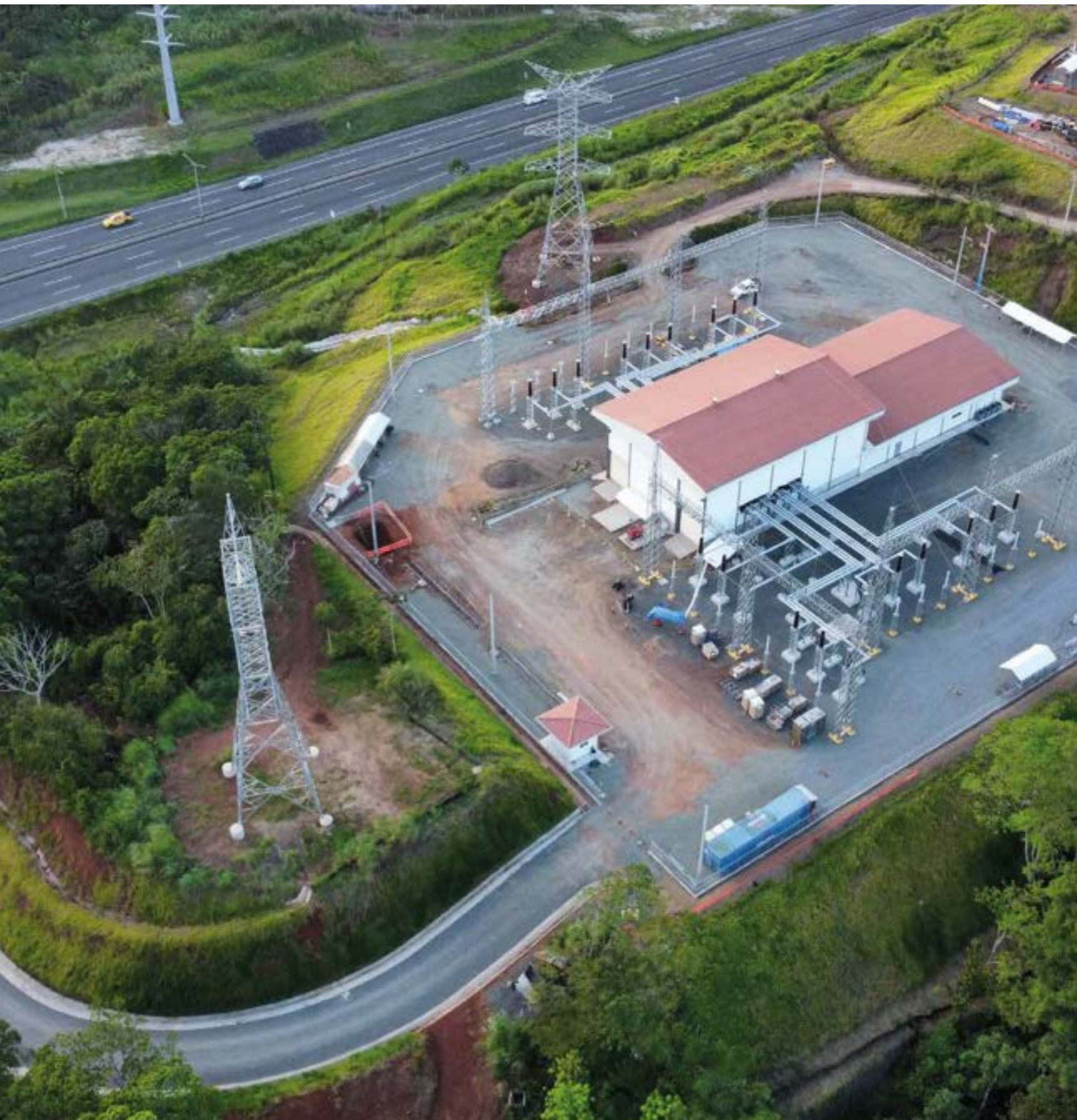
Transmisión eléctrica Sabanitas-Panamá III (Panamá)
