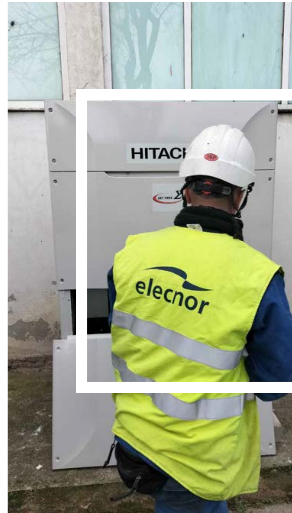
Instalación de climatización en Renault, Sevilla (España)
