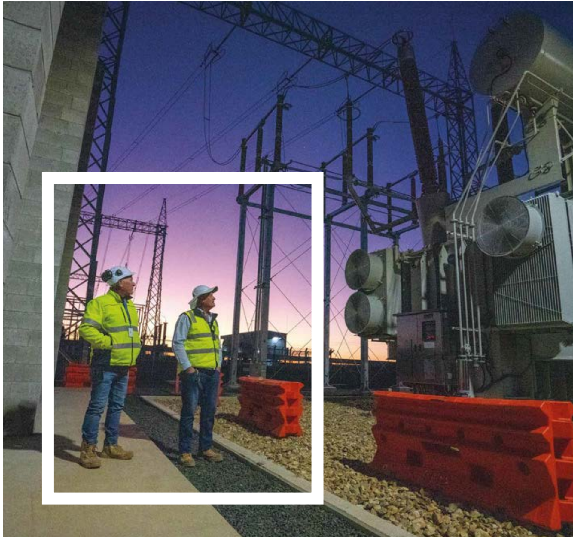
Subestación Parque solar fotovoltaico New England (Australia)
