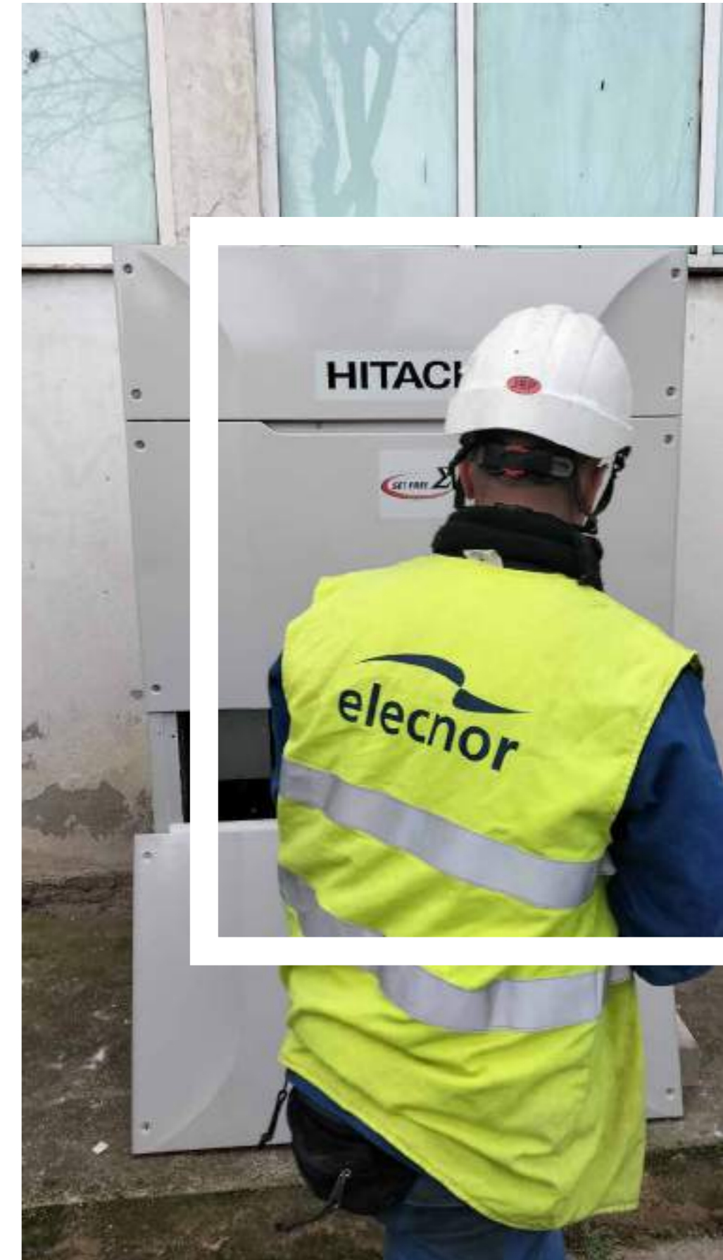
Instalación de climatización en Renault, Sevilla (España)
