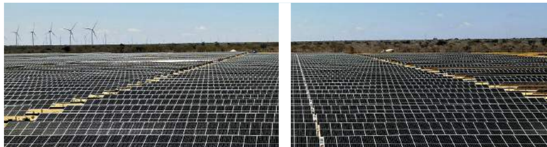
Planta solar fotovoltaica São João do Piauí (Brasil). Celeo
