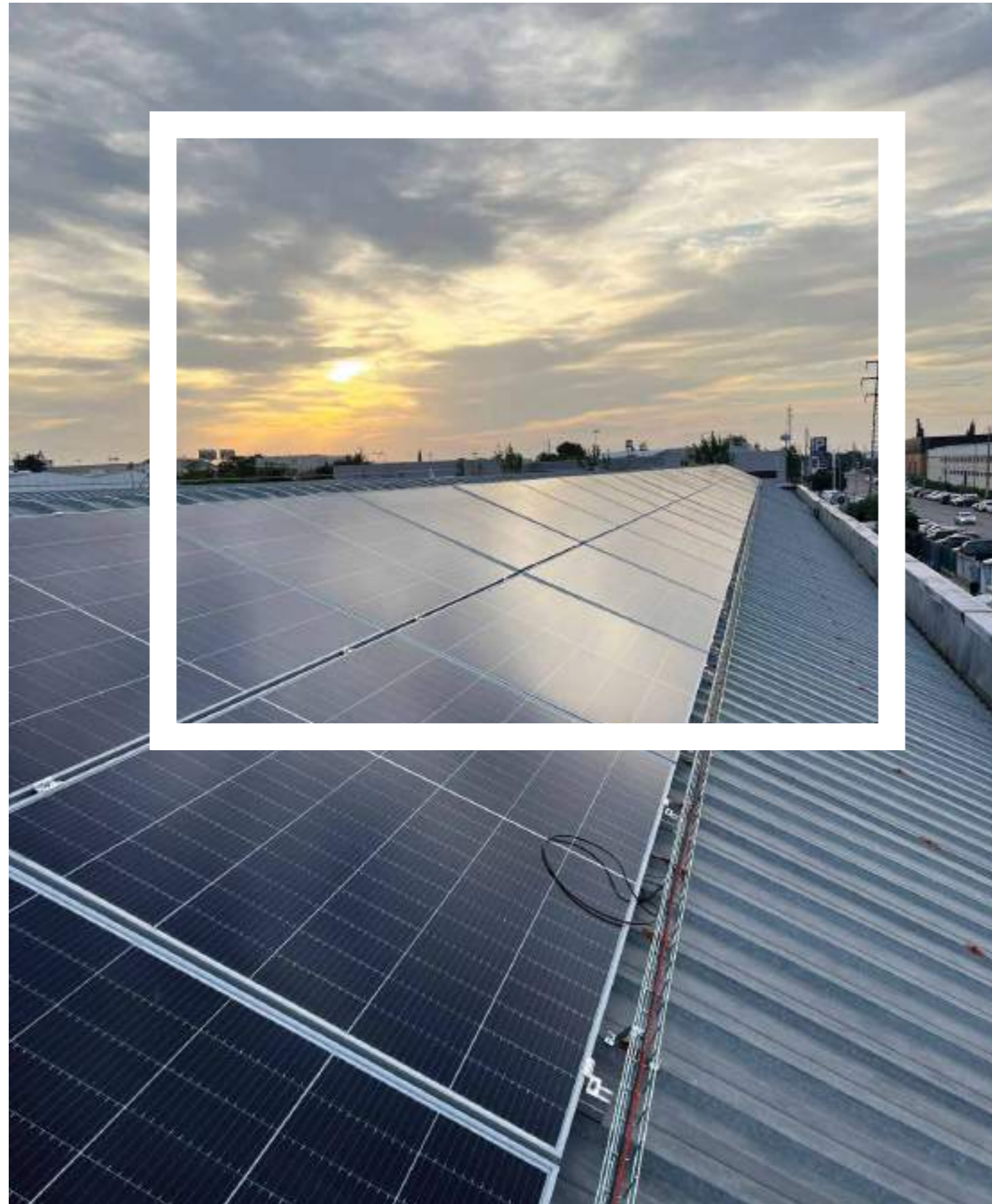
Instalación fotovoltaica para autoconsumo en almacén de Getafe, Madrid (España)
