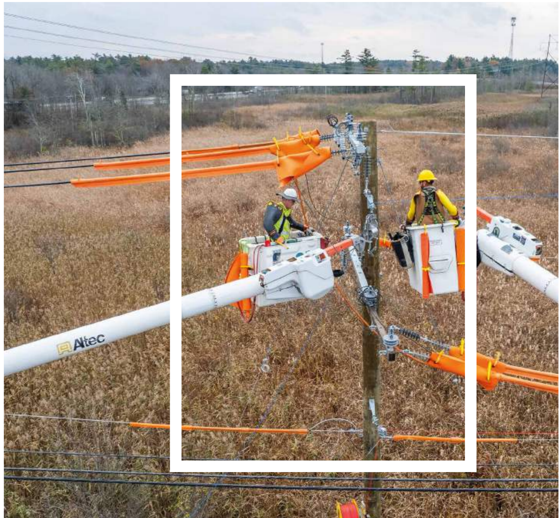
Línea transmisión y distribución en Portsmouth, Newhampshire (Estados Unidos). Elecnor Hawkeye
