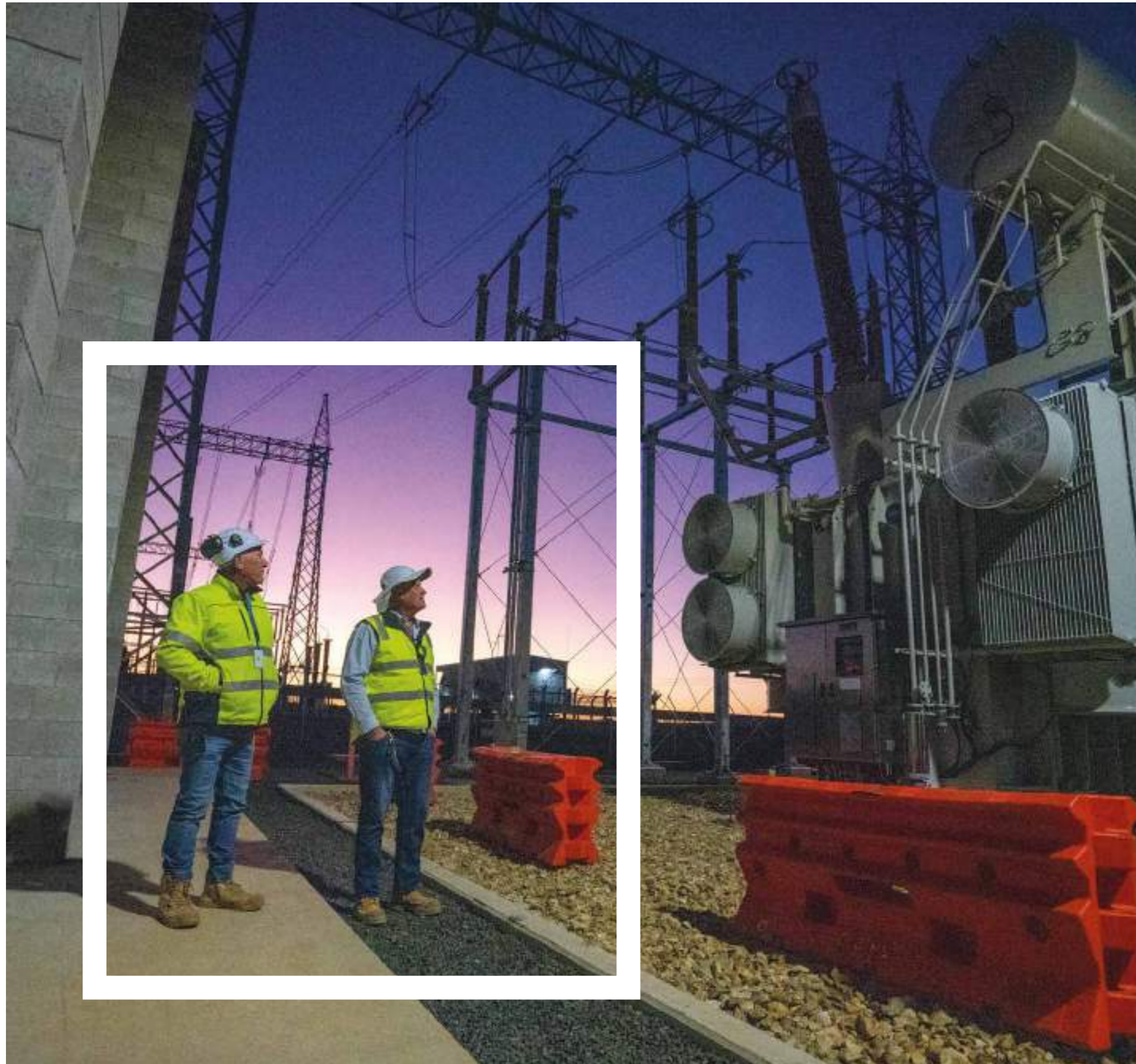
Subestación Parque solar fotovoltaico New England (Australia)
