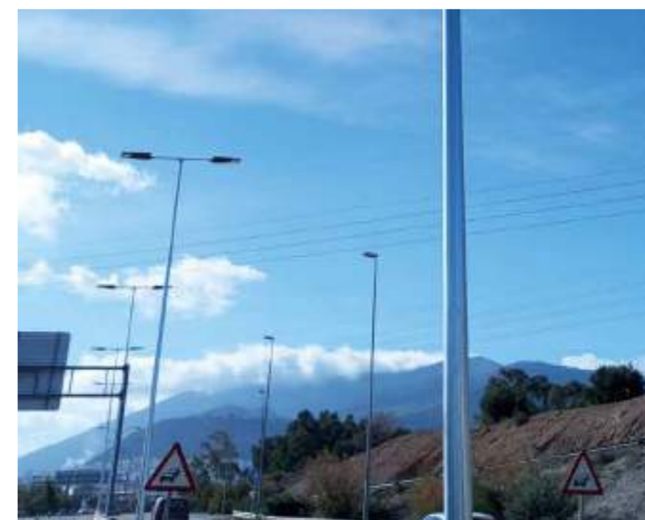
Alumbrado público en carreteras, Jaén (España)
