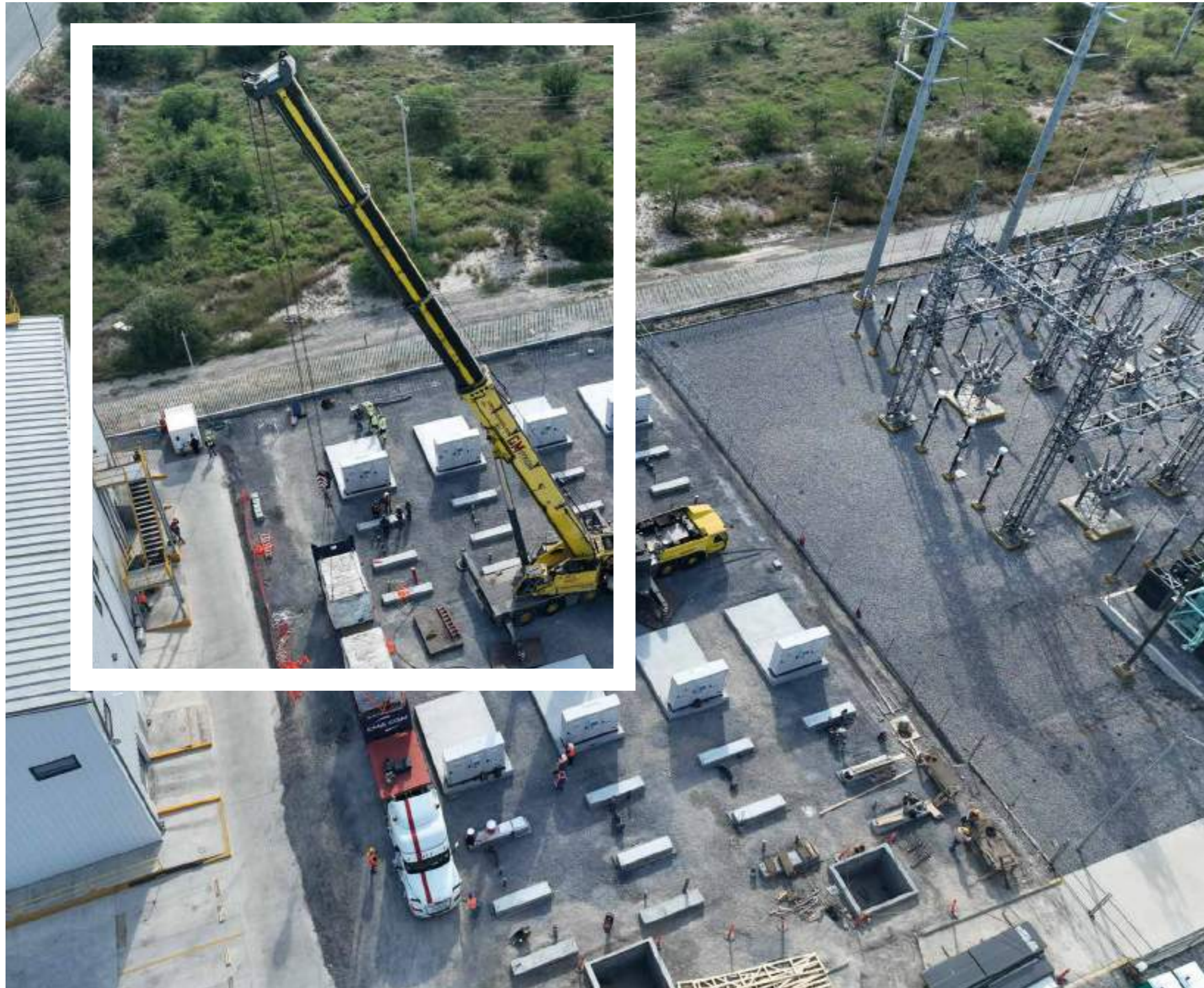
Almacenamiento con baterías BESS en Monterrey (México)
