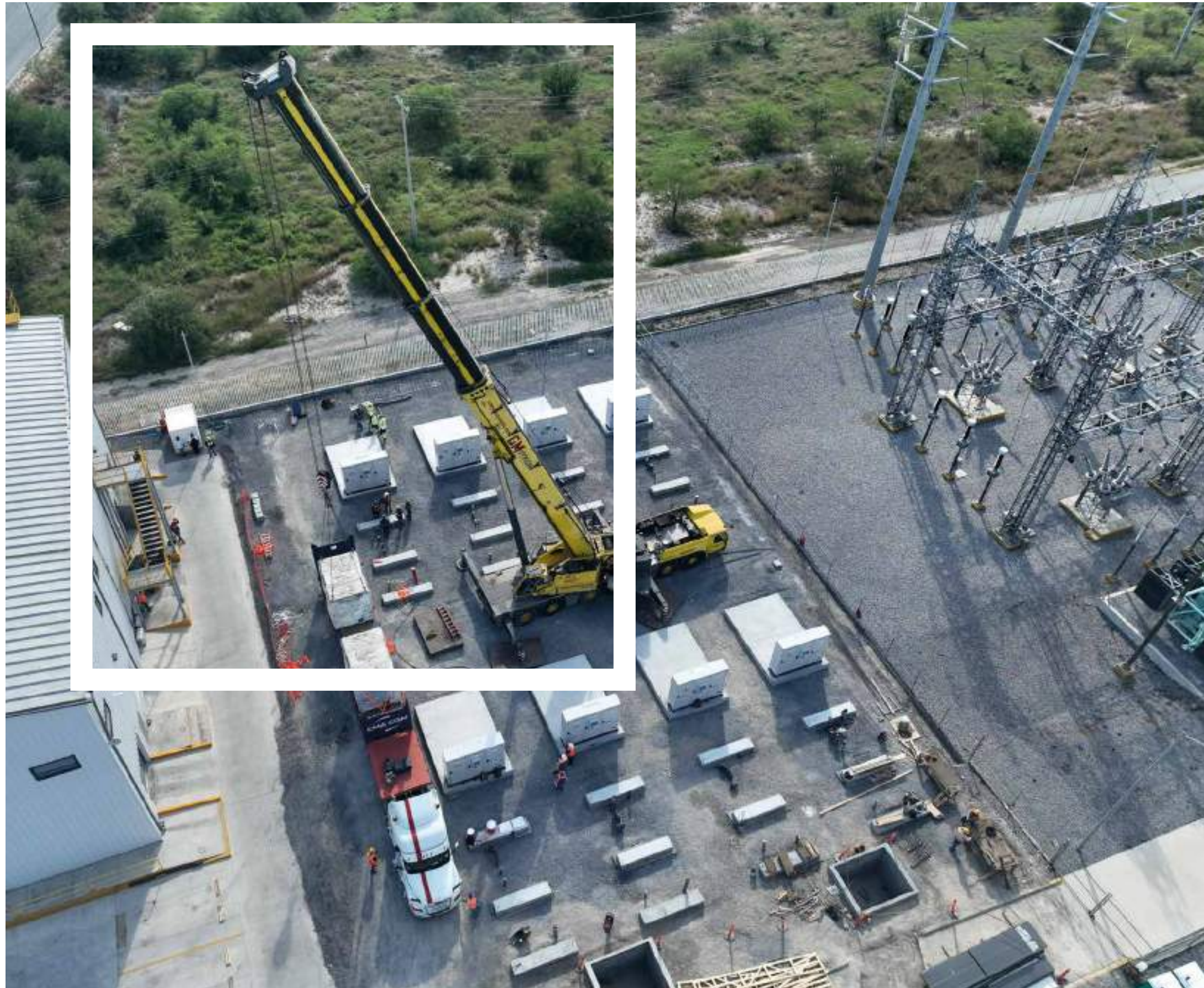
Almacenamiento con baterías BESS en Monterrey (México)
