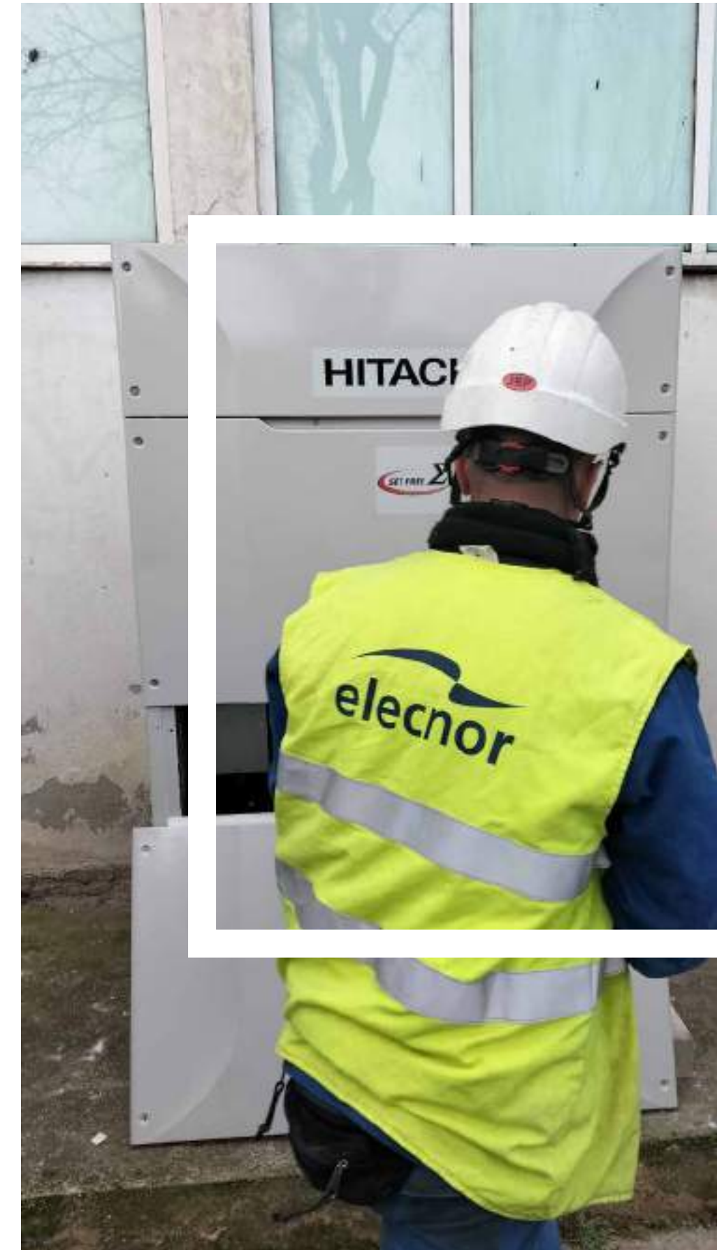
Instalación de climatización en Renault, Sevilla (España)
