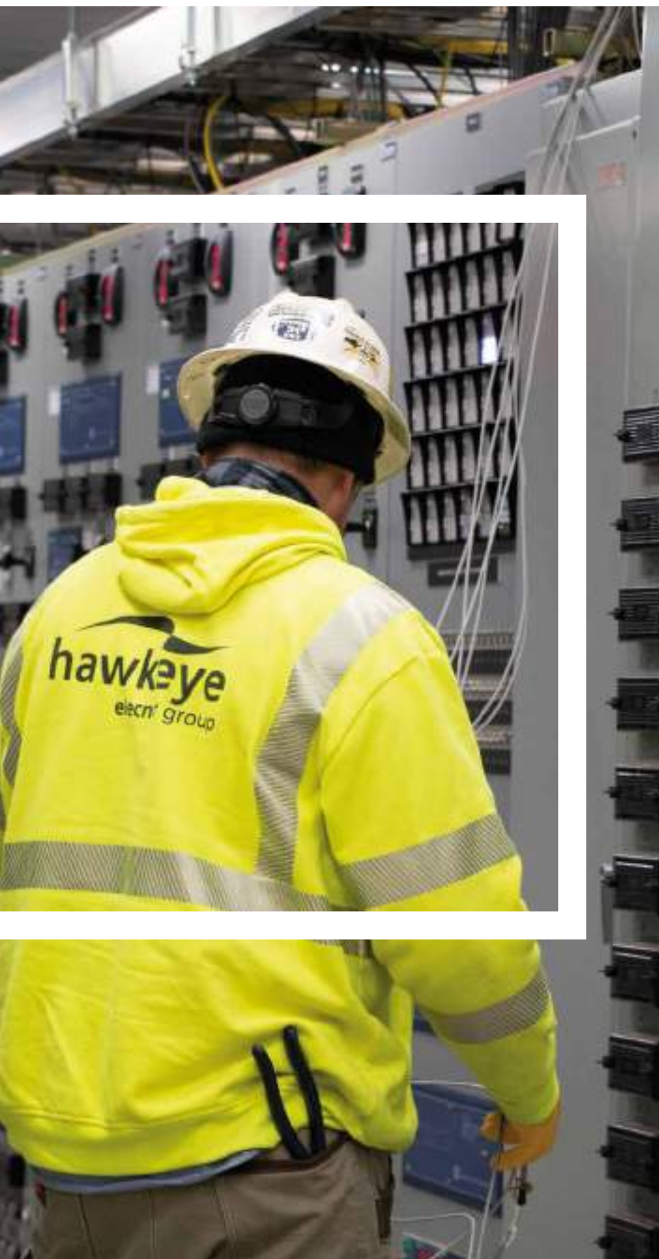
Ampliación de Subestación en Riverhead, New York (Estados Unidos). Elec nor Hawkeye
