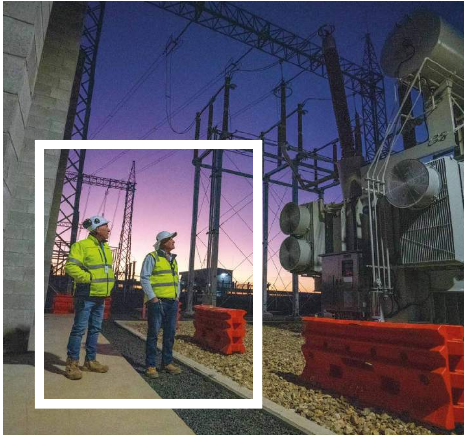
Subestación Parque solar fotovoltaico New England (Australia)
