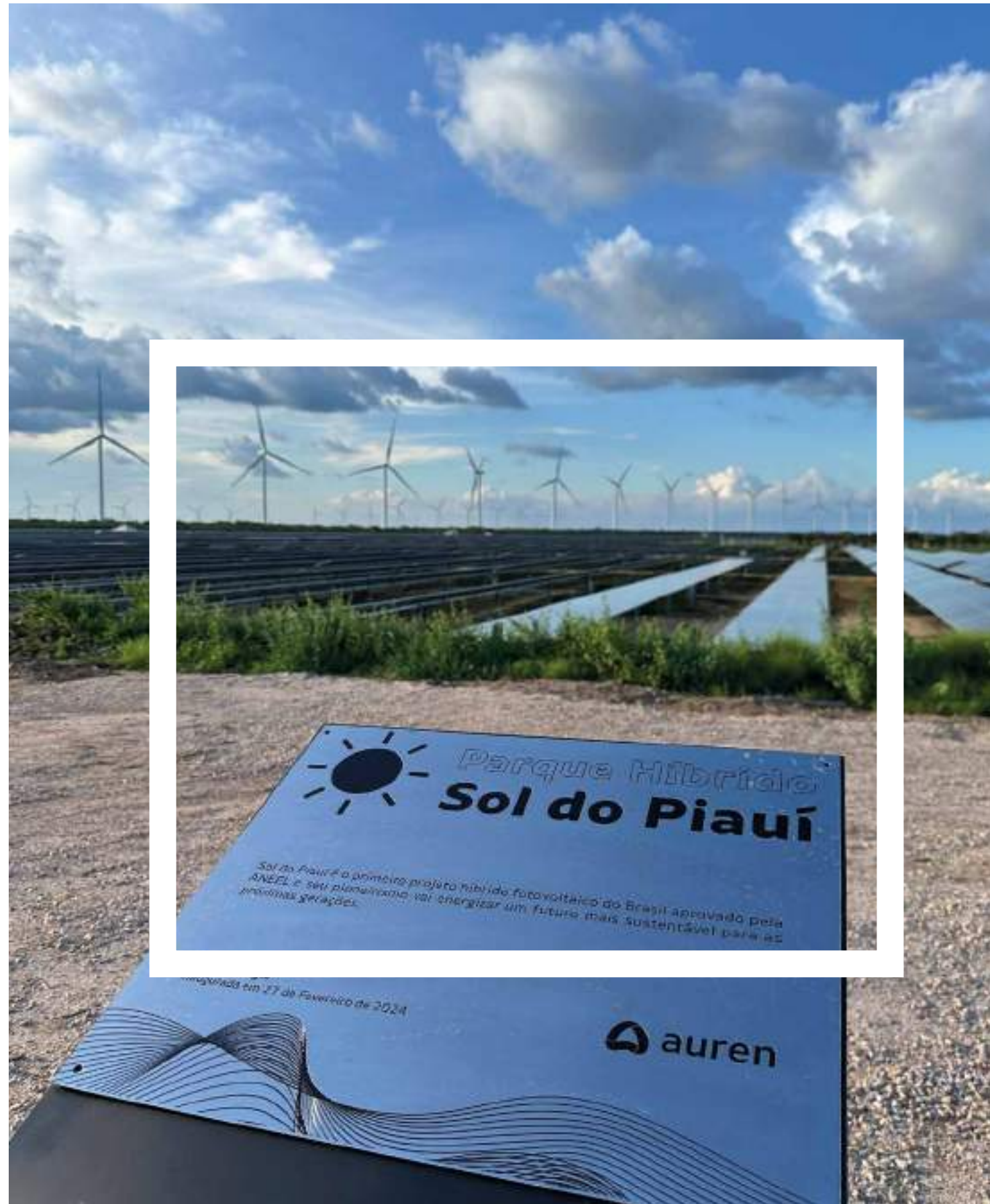
Planta solar fotovoltaica São João do Piauí (Brasil). Celeo
