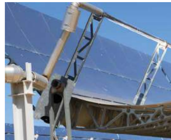
Aste 1A solar thermal power plant in Ciudad Real (Spain)
